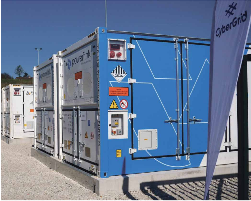
Batteriespeichersystem von Powerlink im Hörschinger Logistikpark von Schachinger in Oberösterreich.
